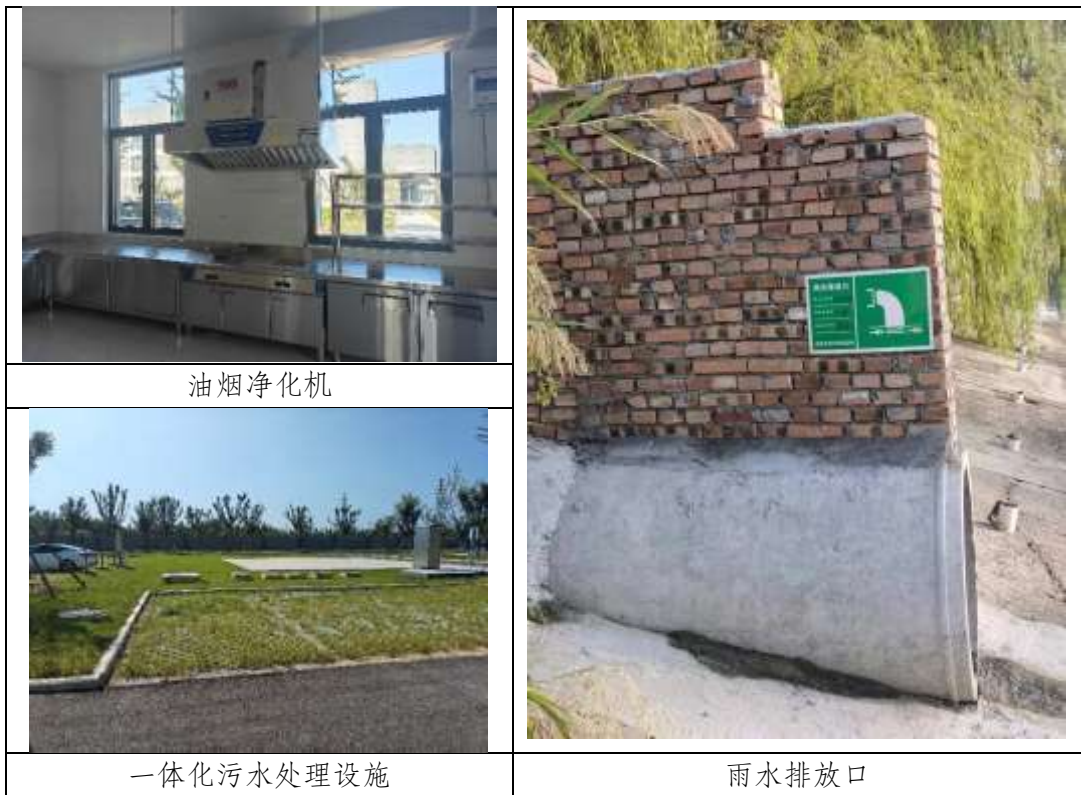
图 4.2-2 项目原水泵站环保设施现场照片
